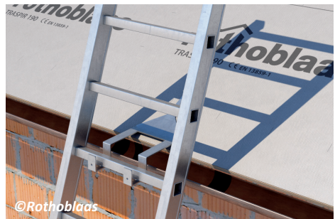
Bei der Erstellung des Gebäudes können stationäre Leiterhalterungen bereits mit eingeplant und errichtet werden; diese sollen logischerweise an den geplanten Zustiegspunkte und weiterführenden Anschlagpunkten gesetzt werden.
