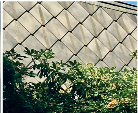
Dachschindel aus Asbest oder nicht... am besten einen Fachmann zu Rate ziehen.
