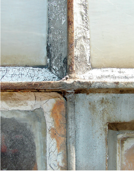
Asbest im Fensterkitt und Dichtungsfugen
