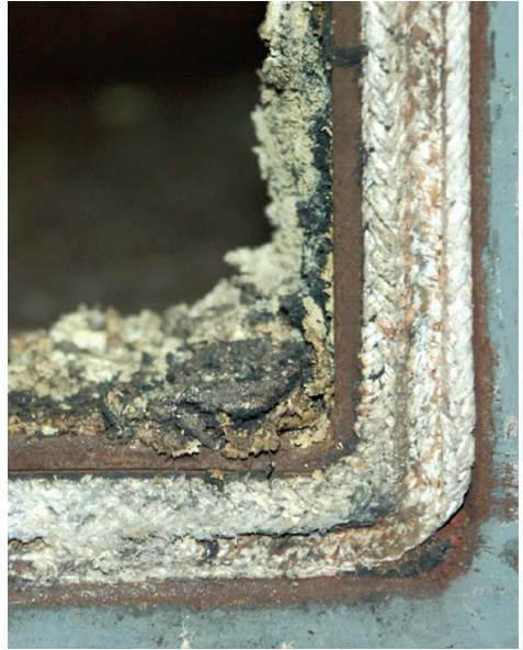
Asbestschnüre bei Heizungen und Kamine
