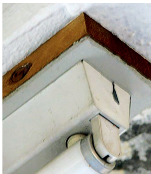
Asbesthaltige Leichtbauplatten unter Leuchtstoffröhren
