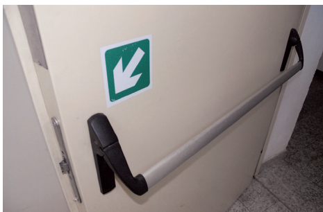
Fluchttür und Brandabschluss mit Drückleiste
